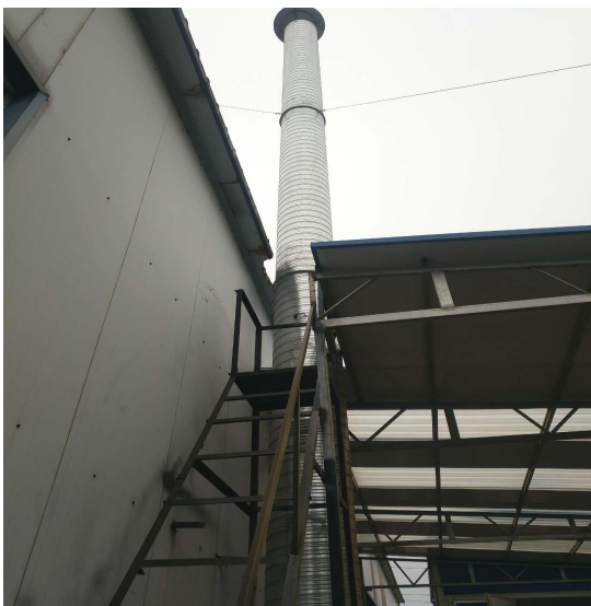
图 3-6 喷漆间排气筒
