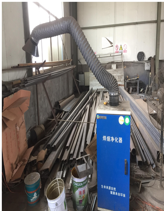
图 3-9 焊烟净化器、排气扇
